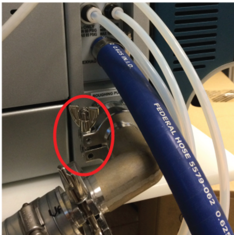
Abbildung 5-15: Richtig installierte Klemme
